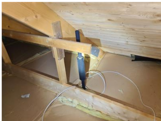
Nockvind, utblås från centraldammsugare mynnar ut pånockvinden.
