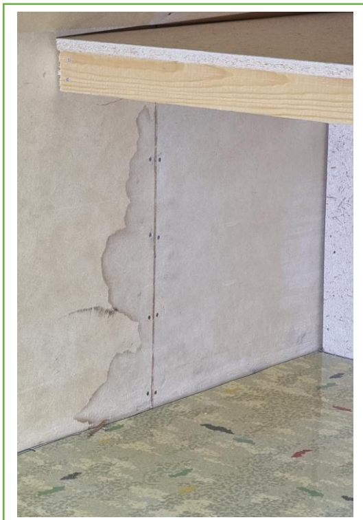
Bild 11: Fuktmärke i kattvind
