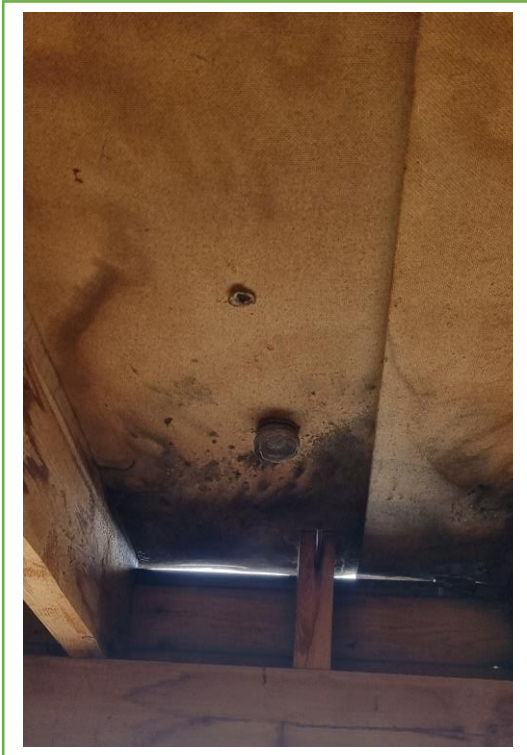
Bild 17: Röttskador i carport.
