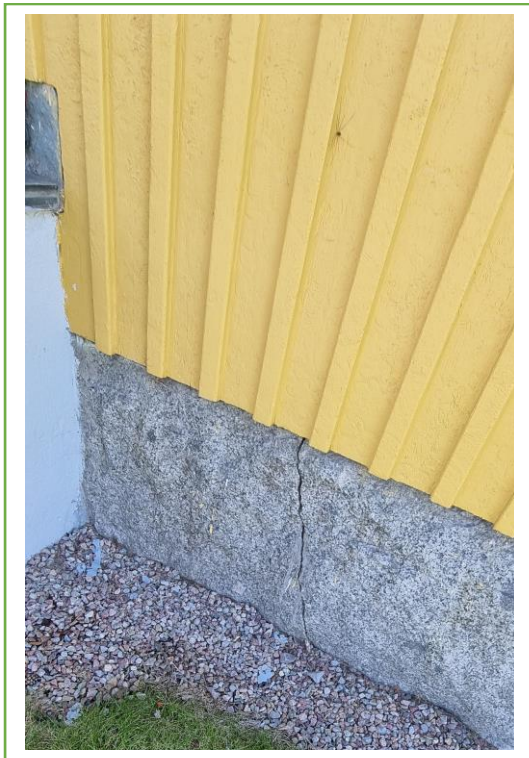
Bild 1: Sprickor i sockel.
