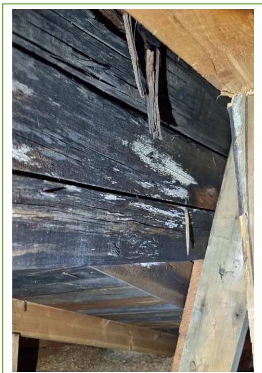
Bild 11: Påväxt på undertak på vind.
