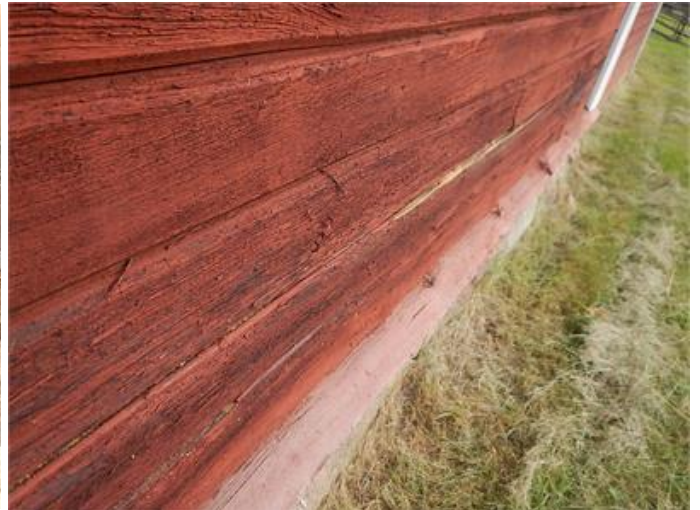
Fasadpanel som släppt i infästning och läcker spån.
